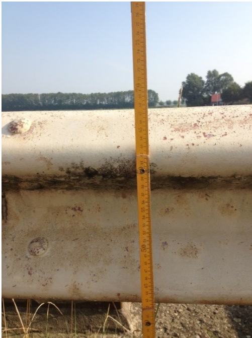
onvoldoende hoogte geleiderail (0,67m i.p.v. minimaal 1,20m)
