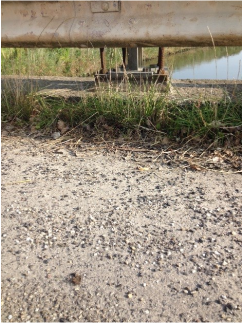
door vangrail moeilijk schoonhouden afwateringsgoot brugdek
