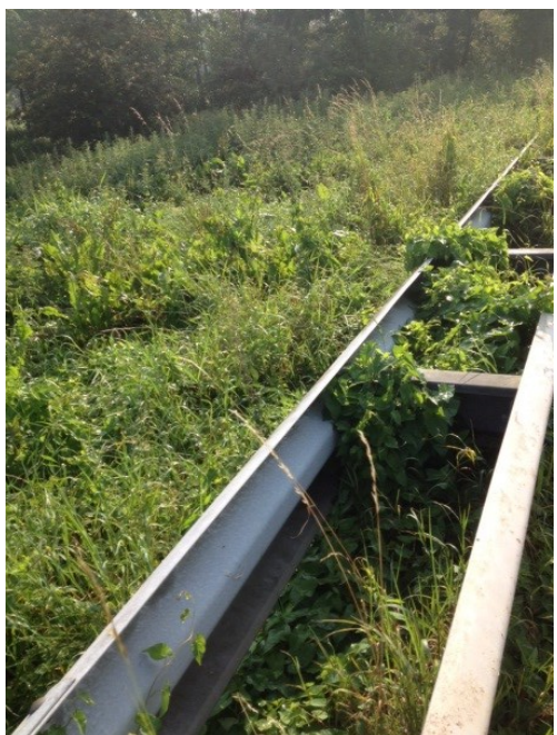
vangrail in berm = zeer lastig bermonderhoud
