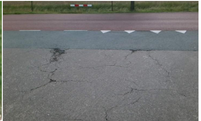
Scheurvorming in asfalt. Voorbeeld van groot onderhoud.
