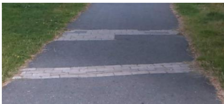
Boomwortelschade in asfalt. Tijdelijk hersteld met bestrating
