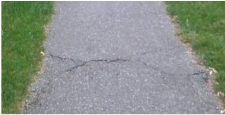
Boomwortelopdruk in asfalt. Voorbeeld van klein onderhoud.
